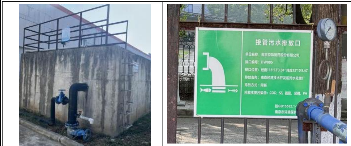
图 3-2 废水处理设施及排口图
